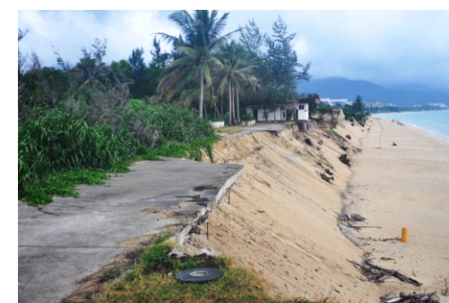
亚龙湾金茂三亚丽思卡尔顿酒店 附近岸线道路损毁状况
